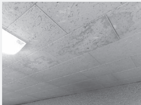
クラブハウス 天井雨漏り
